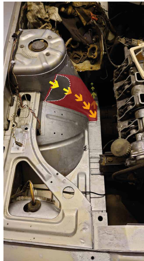
Der im Radhaus verborgene Trichter (farbig kenntlich gemacht), durch den von außen Dreck und Feuchtigkeit in den ungeschützten Längsträger gelangt
