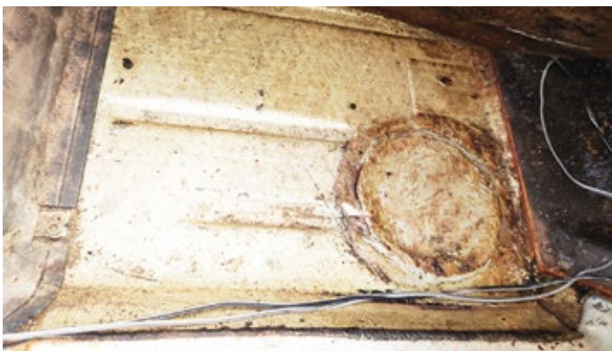
Beifahrerfußraum: nahezu rostfrei
