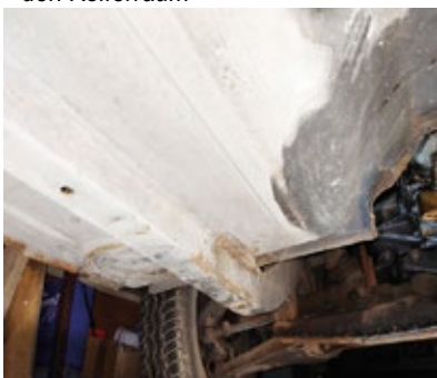
... auch hier nur oberflächlicher Rost
