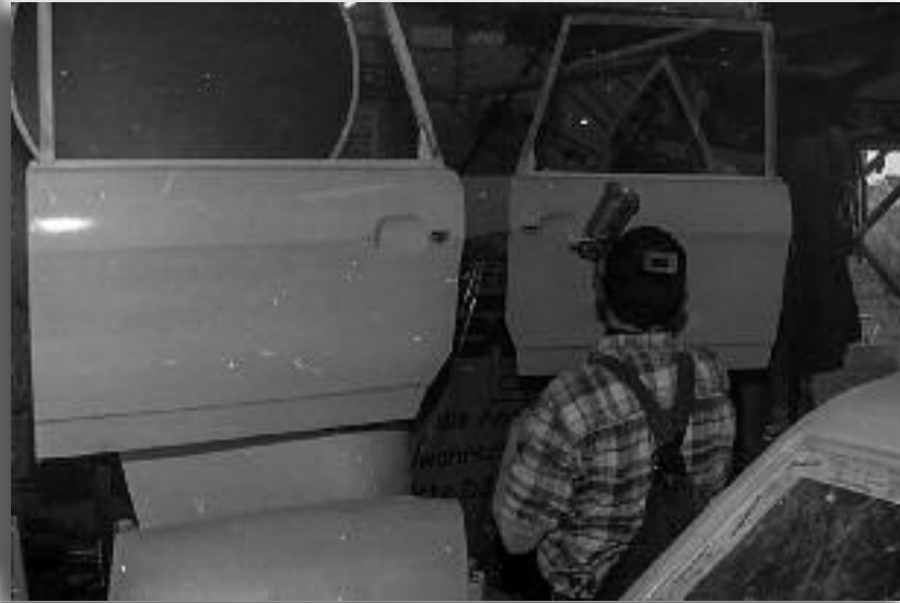
K70-Türen an der Decke = bequeme Arbeitshöhe
